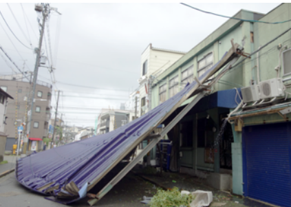
強風にあおられ屋根が崩落しました
